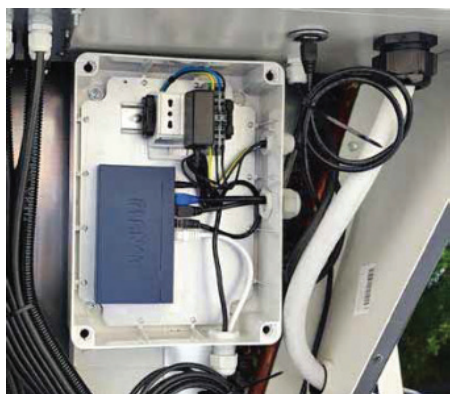
Dessin 16 : Module de connexion cascade avec câblage Ethernet
